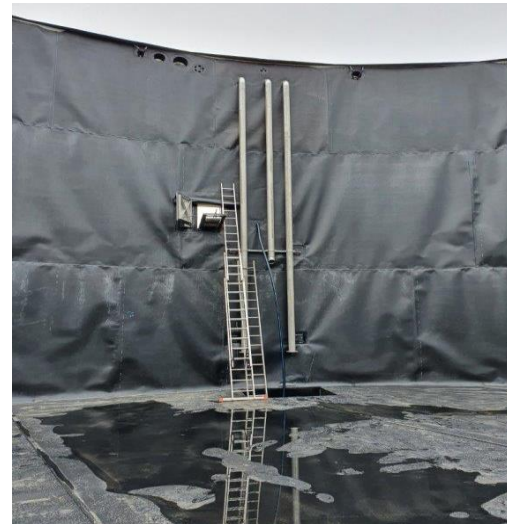
flüssigkeitsundurchlässige Rückhalteeinrichtung mit Leckagesonden
