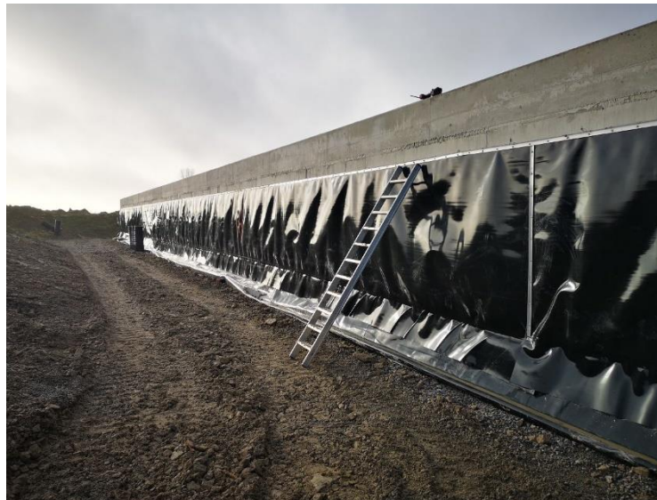
JGS Anlage (Stallanlage)
