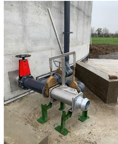
Güllebehälter mit Abfüllplatz, Spindel- und Flachschieber sowie ein Innenschieber
